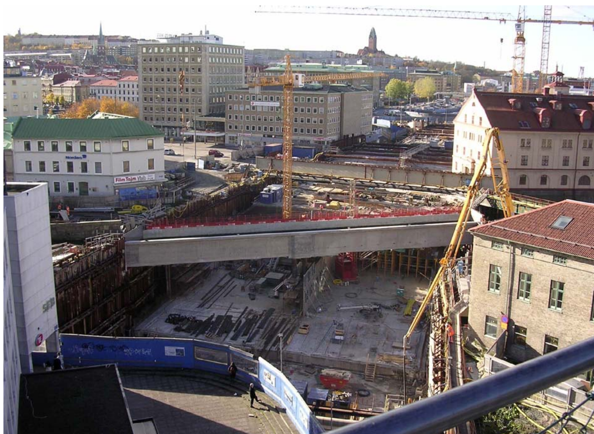
Figur 2. Exempel på schakt vid bygget av Götatunneln där Rosenlundskanalen leddes i en akvedukt över byggschaktet. Kring en arbetsplats kan det uppstå buller, vibrationer och damm som är störande för omgivningen. Samtliga konsekvenser kommer att beskrivas i prövningen.
