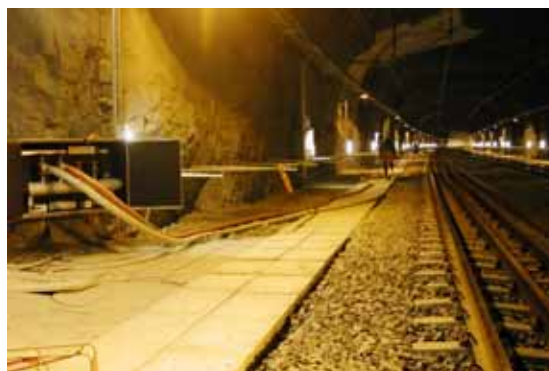
Figur 35 Gångväg vid sidan av spåret och uttag för brandvatten i Åsatunneln.
