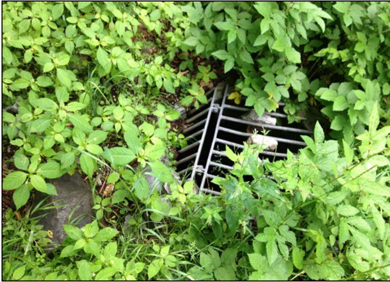
Figur 8. Inlopp till befintlig dagvattenledning i grönområdet vid Annedal
